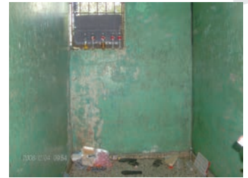
Vista Interna Celdas
